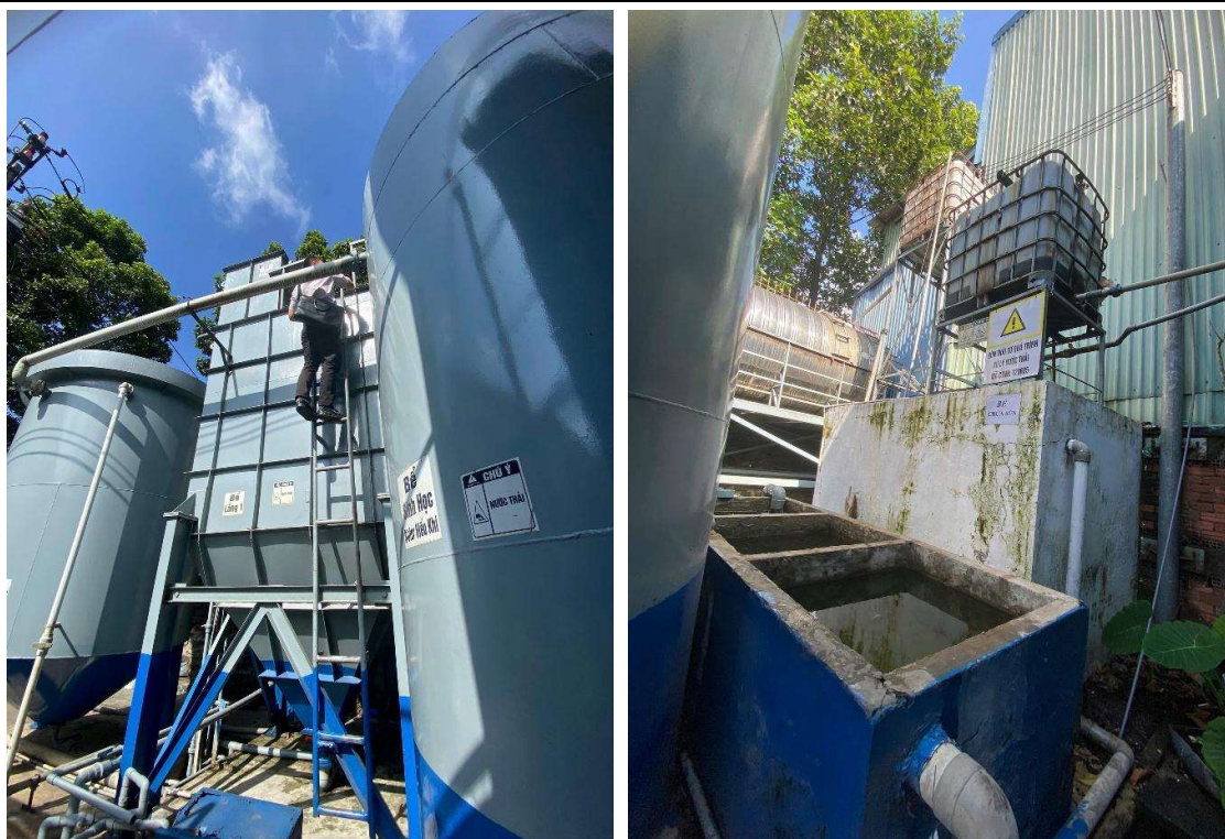
Hình 3.6: Hệ thống xử lý nước thải 200 m³/ngày
