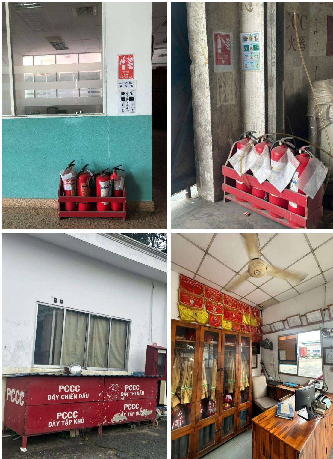
Hình 3.26: Hình ảnh trang thiết bị PCCC
