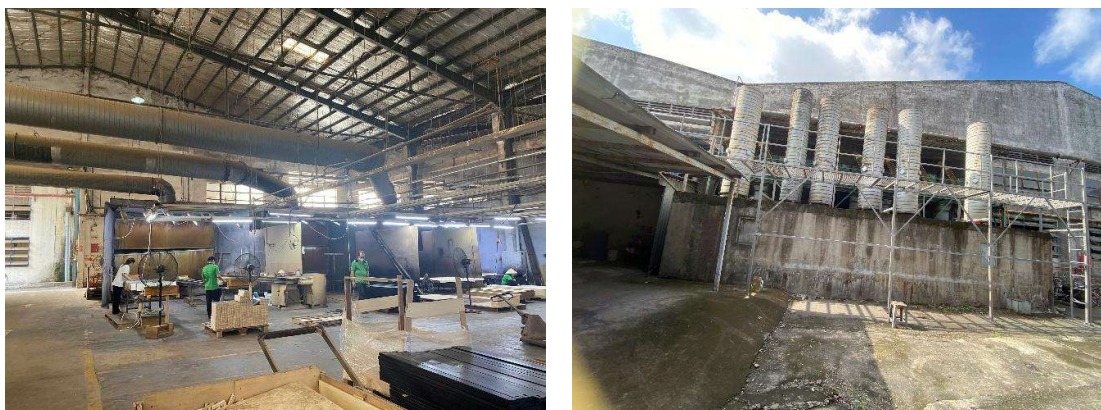
Hình 3.16: Hệ thống xử lý sơn màn nước
