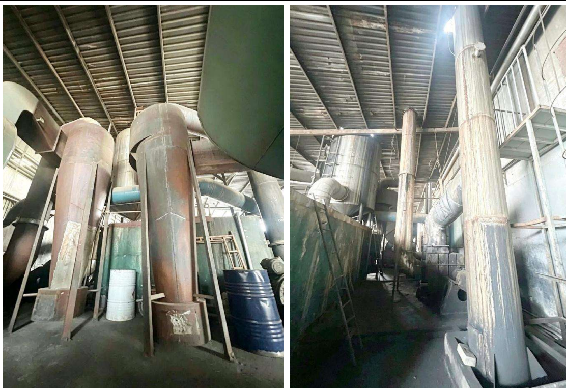
Hình 3.20: Hệ thống xử lý khí thải lò hơi
